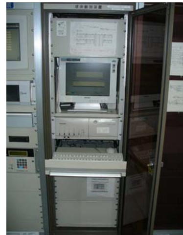
堤体観測装置全景
