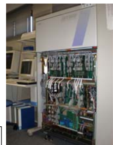
電話交換機内部
