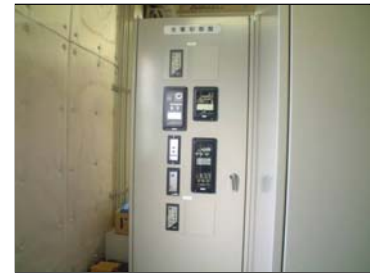
受電制御盤全景
