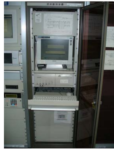
堤体観測装置全景
