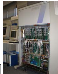
電話交換機内部
