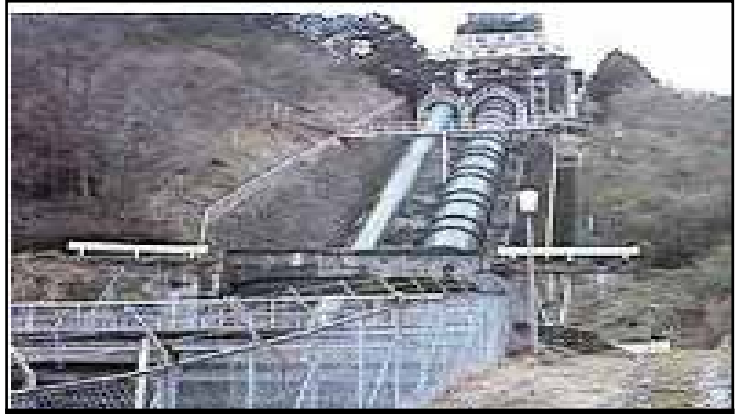
西吉野第二発電所
