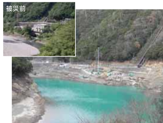
長殿発電所被災箇所
