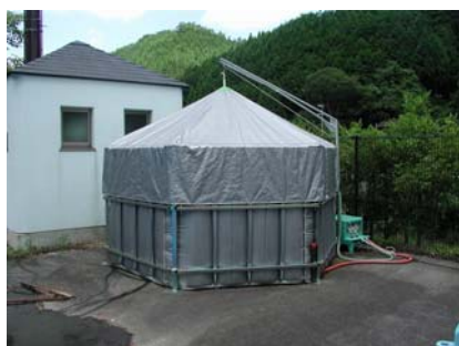
堆肥製造装置（チップ材発酵中）
