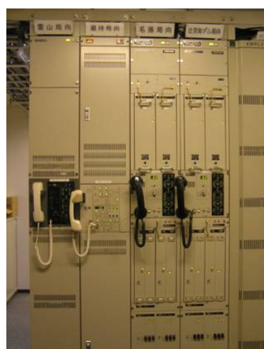
多重無線装置
