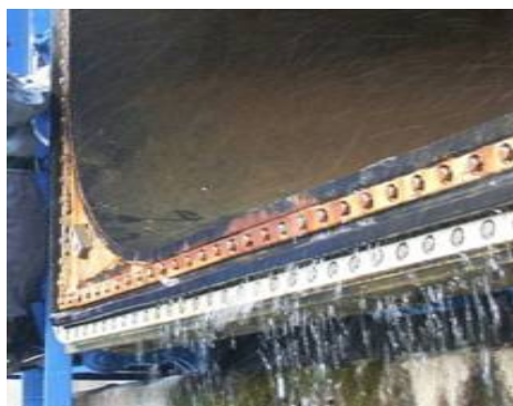
漏水量（放流管下流端）
