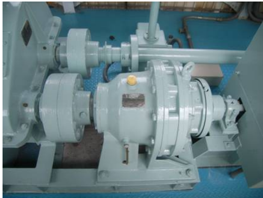
非常用ゲート整備前
