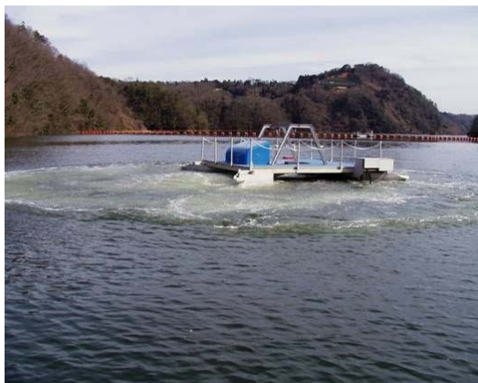
＜曝気循環設備＞
