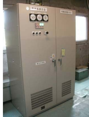
(通信用直流電源設備：施工後)
