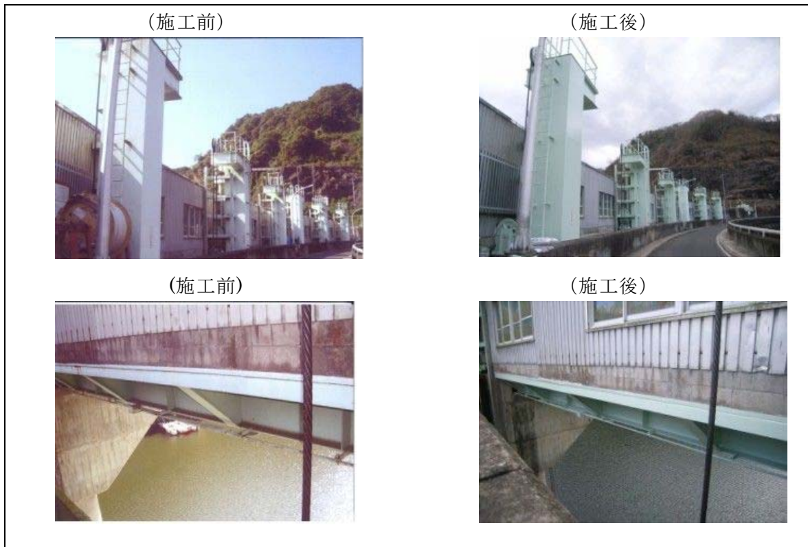
図 1.3.1-4 非常用洪水吐クレストゲート開閉装置外塗装(平成 18 年度)
