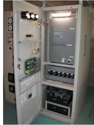
(始動用直流電源設備：施工後)
