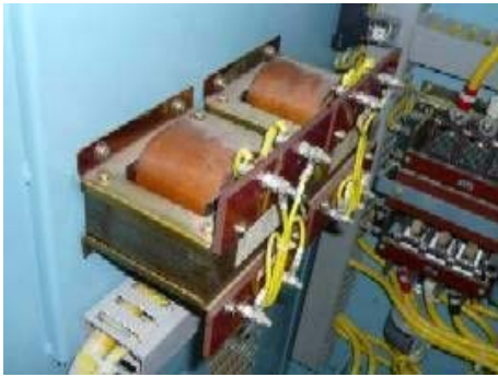
発電機盤(盤内)
