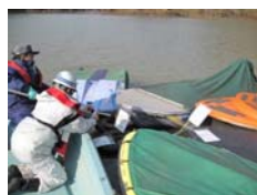
図 7.7-1 撤去前後の状況
