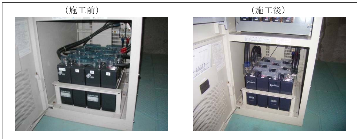
図 1.3.1-21 始動用直流電源装置整備工事(平成 19 年度)
