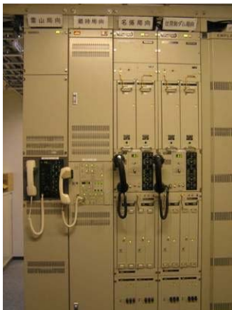
多重無線装置
