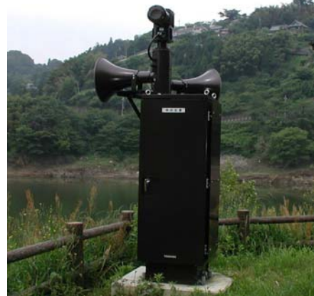
水質画像監視装置設置状況
