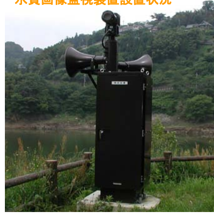
水質画像監視装置設置状況
