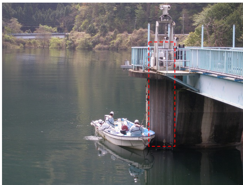
図 2-8 水質自動監視装置の設置状況 (初瀬)
