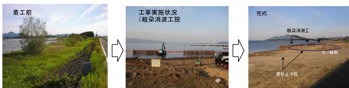
粗朶消波工とヨシの植栽により地盤の安定化を行う (2007年12月時点)
