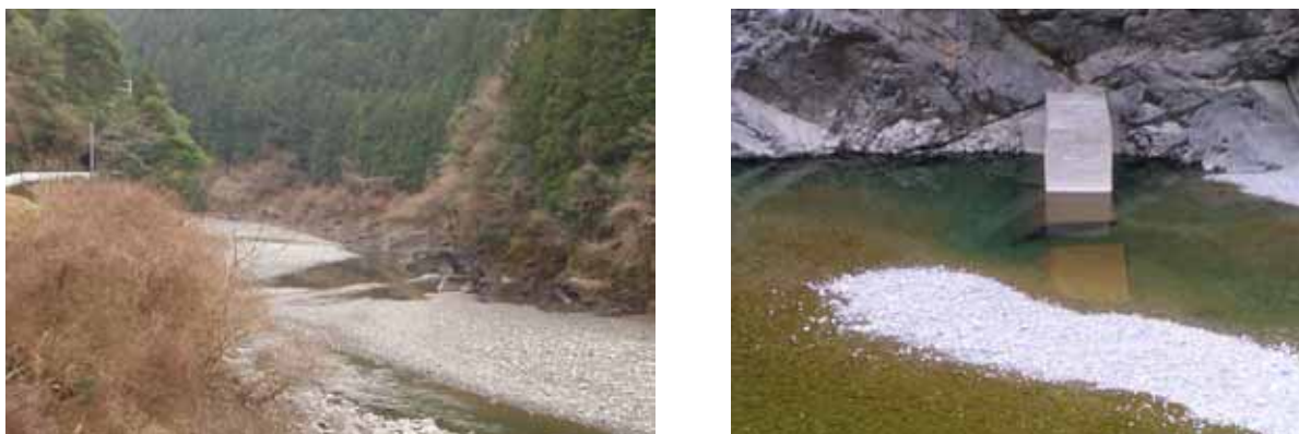
図 4.4 - 2 貯砂ダムにおける堆砂の状況（左：全景、 右：貯砂ダム状況）
