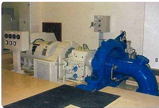
写真 3.3 - 1 ダム管理用発電施設
