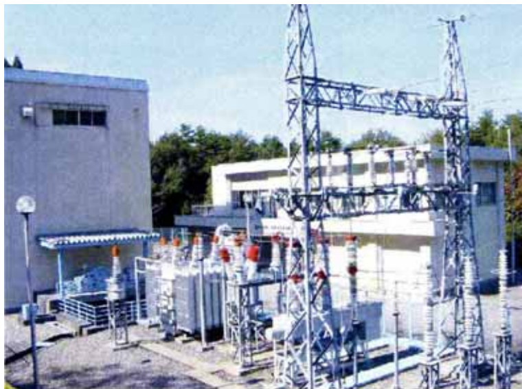
真名川発電所
