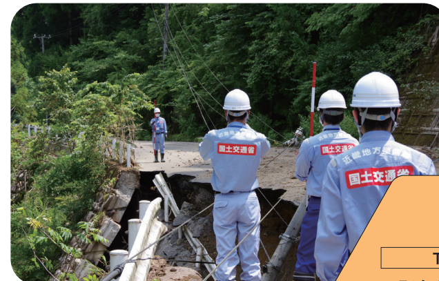
緊急災害対策派遣による被災地調査
