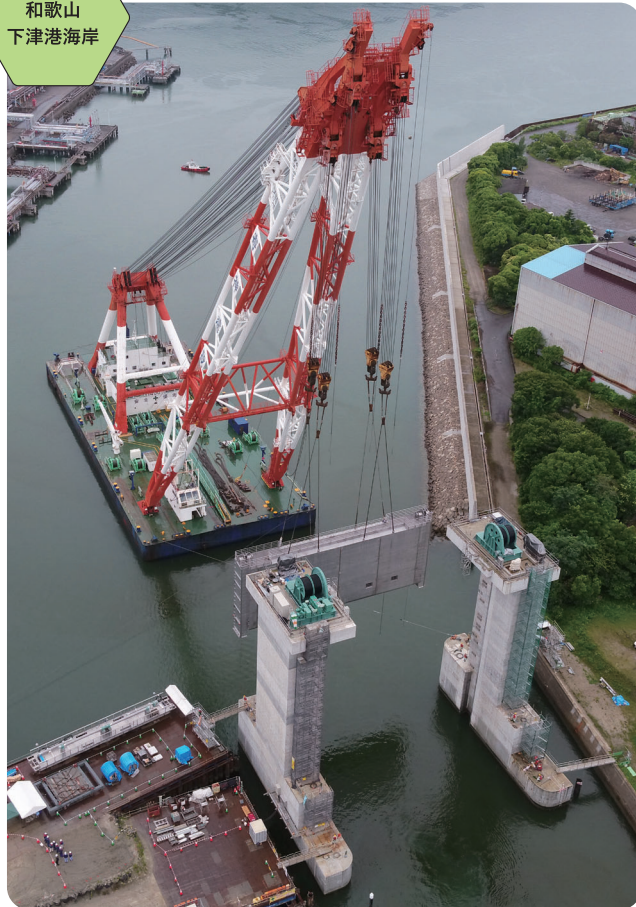
南海トラフ地震による津波来襲から人命・財産を守るため、護岸や水門など津波対策を進めています。
