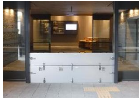
▲防潮板を使用した様子
