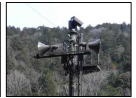
放流警報装置
