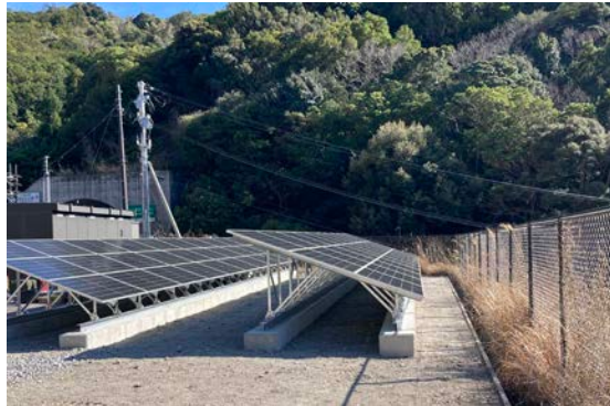
▲トンネル坑口付近の敷地を活用した整備事例 (近畿自動車道紀勢線 十九淵トンネル電気室)
