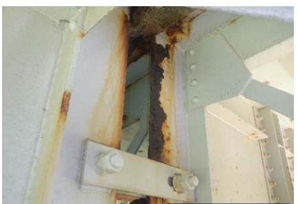
令和2年10月撮影 主桁の腐食
