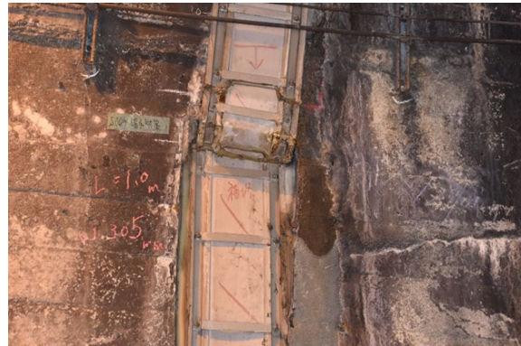
アーチ部からの漏水
