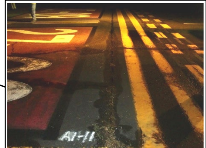
誘導路の劣化状況
