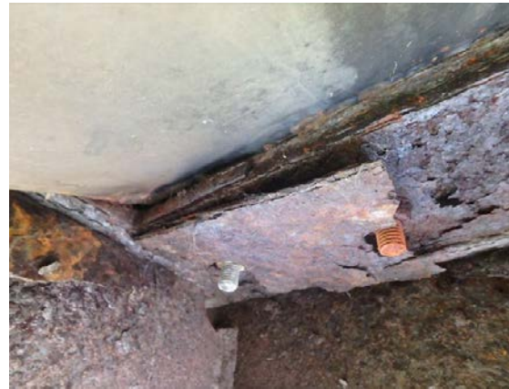
鋼床板(補強部材)の腐食・層状剥離
