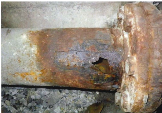
配管腐食状況
