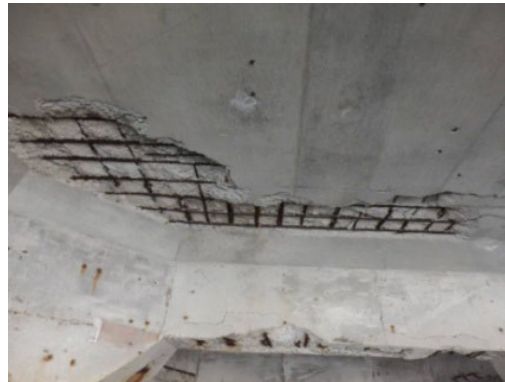
【上部工のコンクリート剥離、鉄筋腐食】
