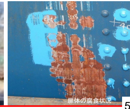
水密ゴムの破損状況
