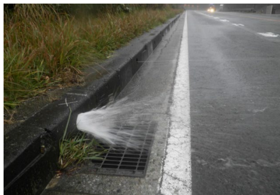
散水不良の状況
