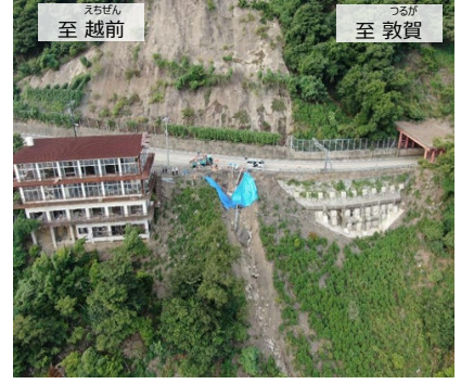
写真2 令和4年8月豪雨時の被災状況
