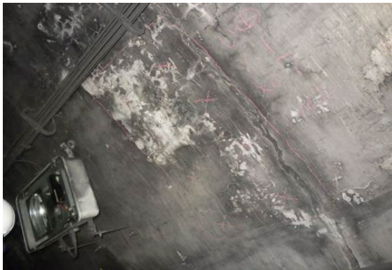
既設剥落防止材の劣化
