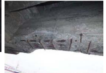
【脚柱部、上部工はり部のコンクリート剥離、鉄筋腐食】
