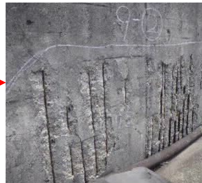
施設老朽化状況
