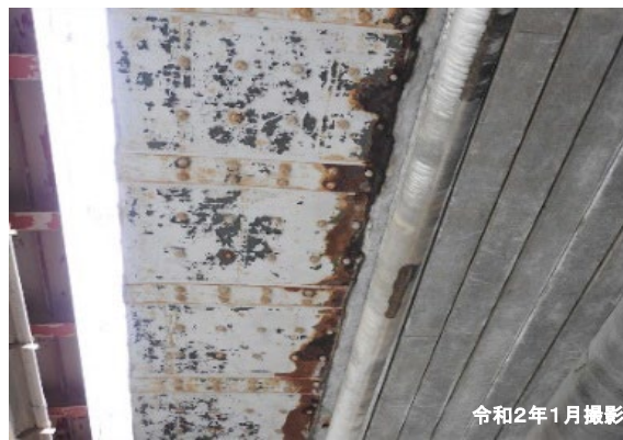
補強鋼板の腐食
