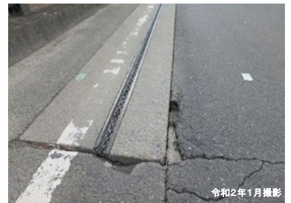
縦目地部の損傷
