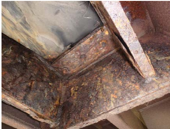
鋼床板(補強部材)の腐食
