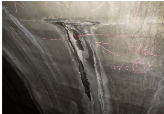
覆工からの漏水
