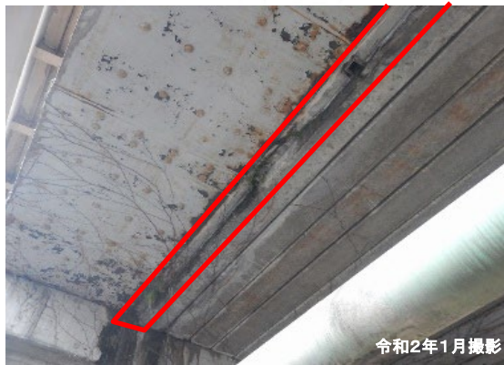
縦目地部の遊離石灰(漏水)
