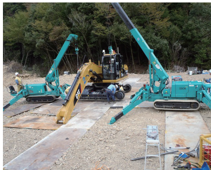
カニクレーン（分解型）を使用して油圧ショベル（分解型）を組立（長殿地区）
