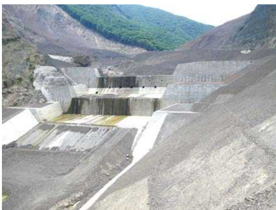
赤谷地区 2号砂防堰堤【平成 28 年 3 月完成】
