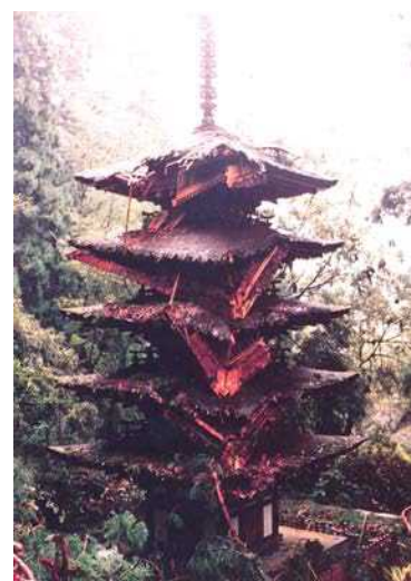
台風 7 号で深い傷を負った 室生寺・五重塔
