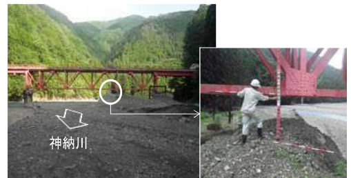
土砂流出による河床上昇 (神納川 藤原橋付近 (十津川村))
