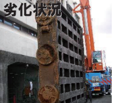
排水機場ゲートの劣化状況
