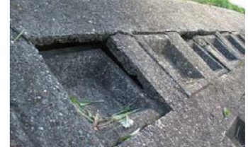
護岸の損傷状況
