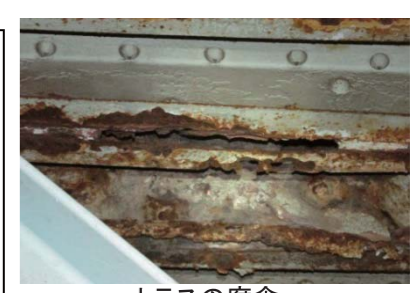
トラスの腐食
