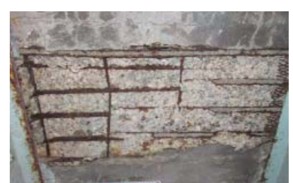
床版の剥離・鉄筋露出
