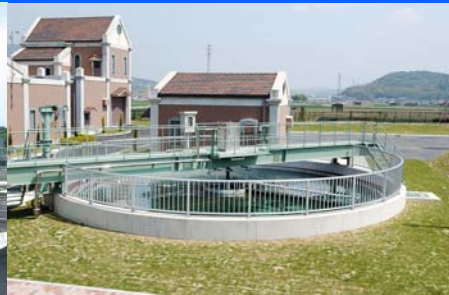
南あわじ市広田浄化センター 水処理施設
