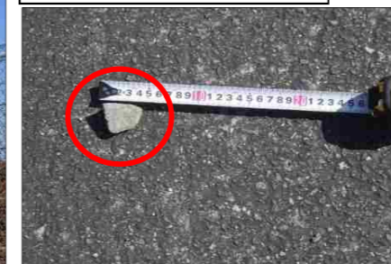
事故状況写真③ 飛散したコンクリート片
