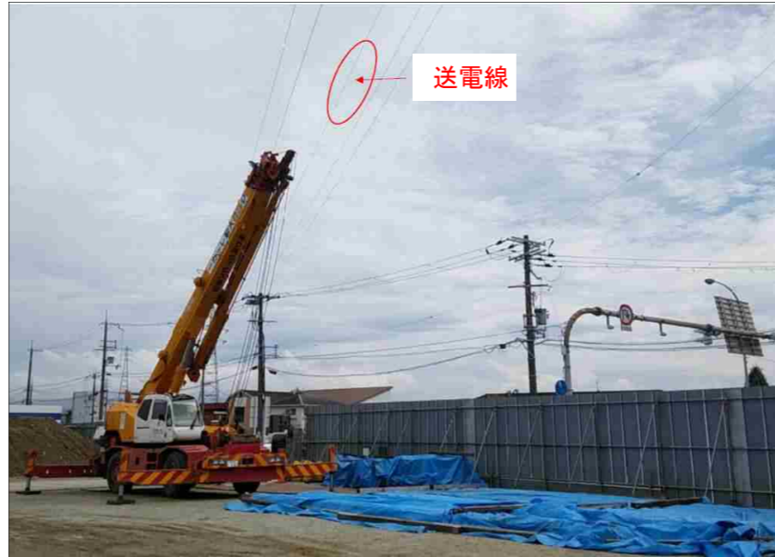
事故状況写真①
