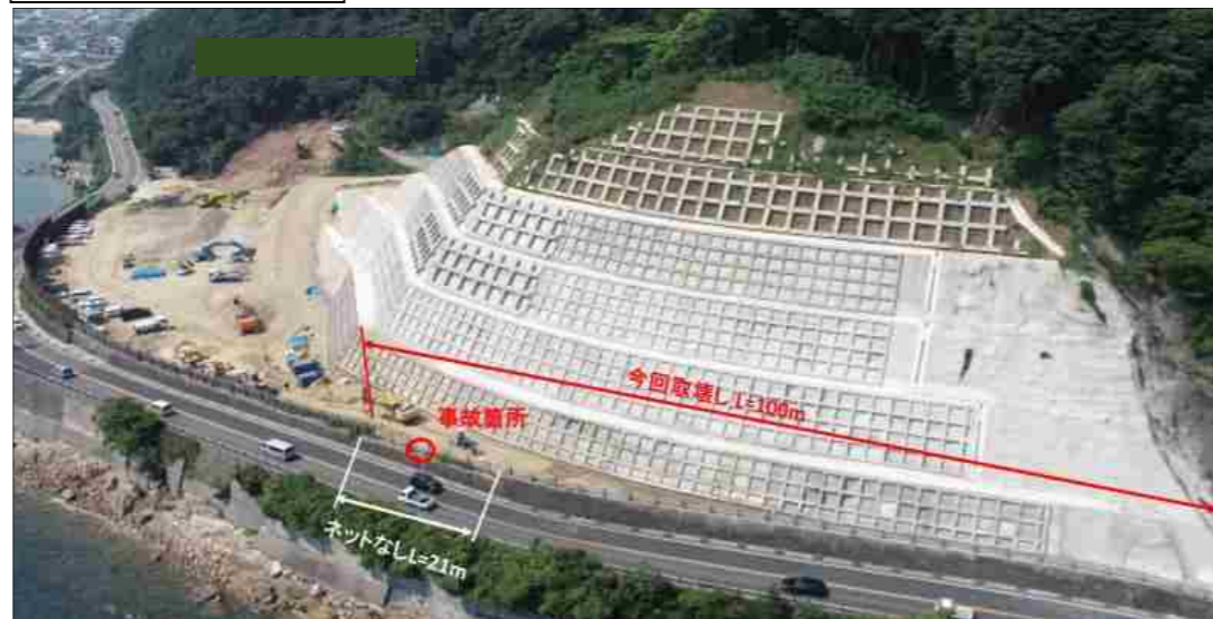
事故状況写真①
