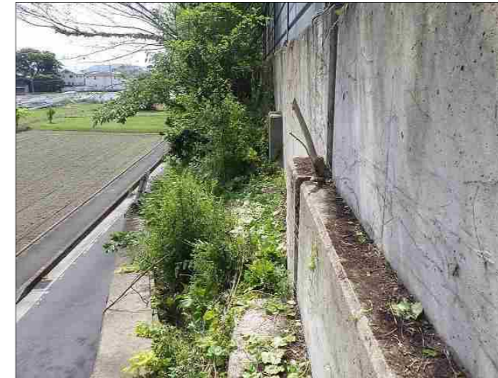
事故状況写真②
