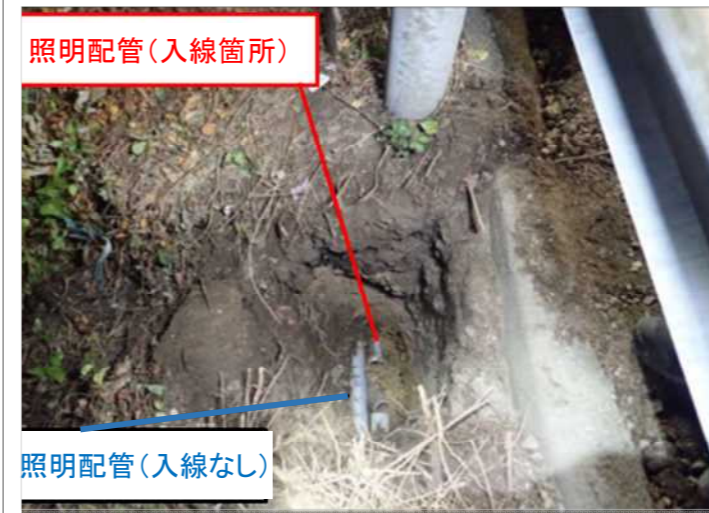
事故状況写真①
