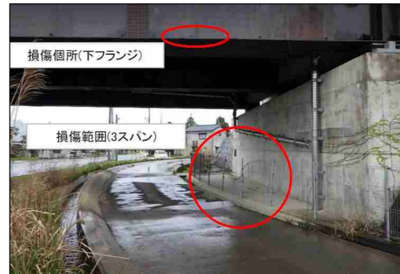
事故状況写真①
