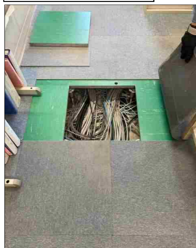
事故状況写真①
