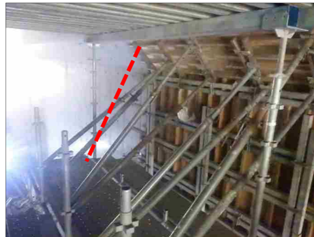
パイプサポート落下箇所
