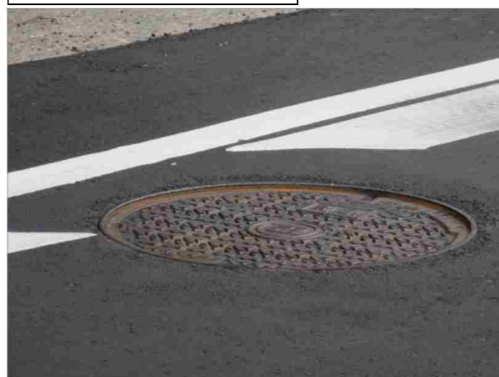
破損直前の蓋の状況(約10mm程度蓋の沈下がみられる)
