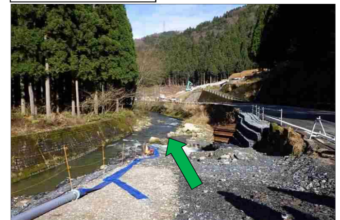
事故状況写真②
