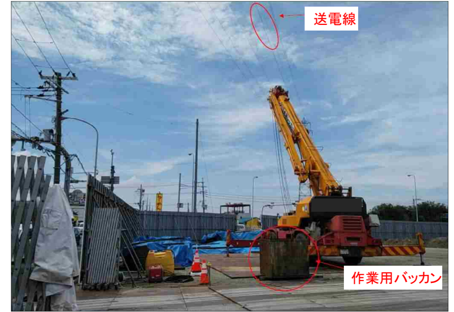
事故状況写真②
