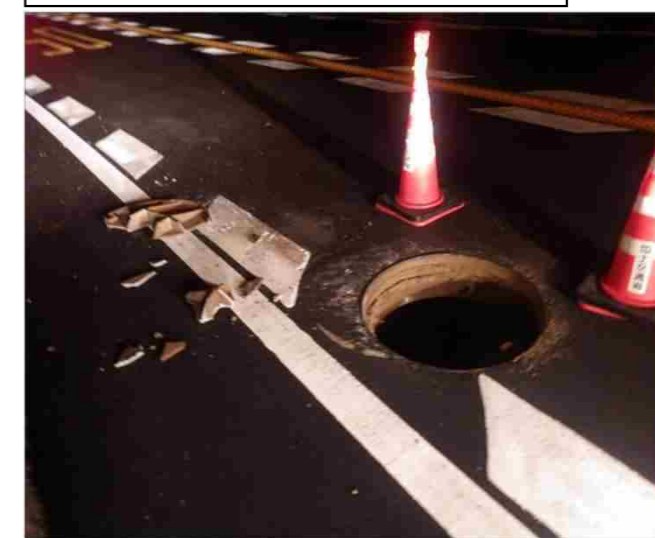
事故状況写真② マンホール破損状況
