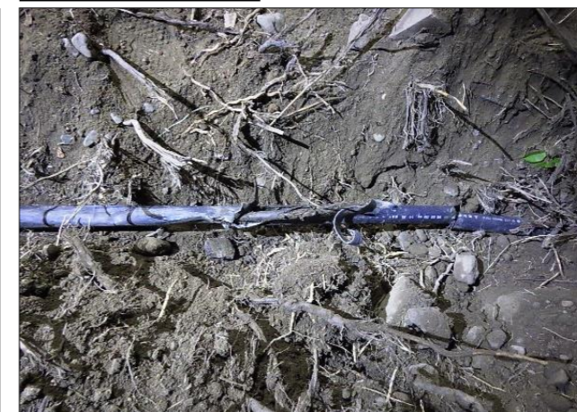
事故状況写真②
