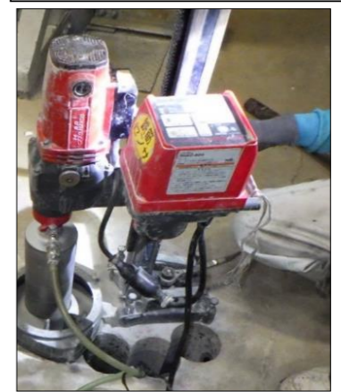
事故状況写真⑤ コア抜き機
