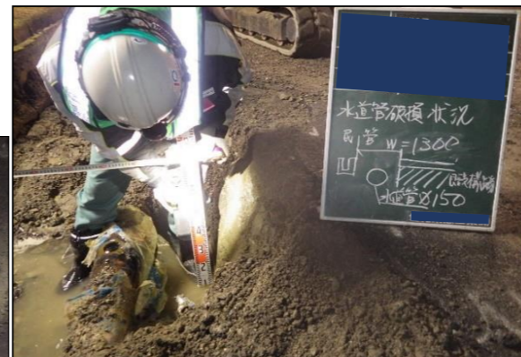
事故状況写真② 近景状況
