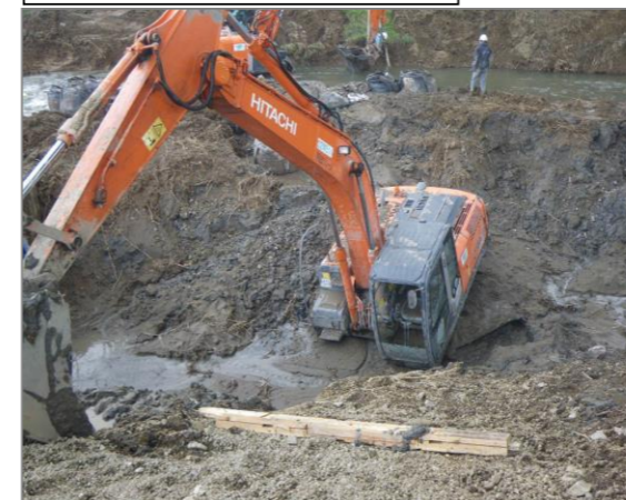
事故状況写真② 排水処理後
