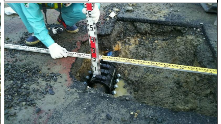
事故状況写真②
