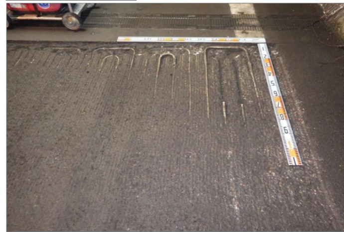
事故状況写真①
