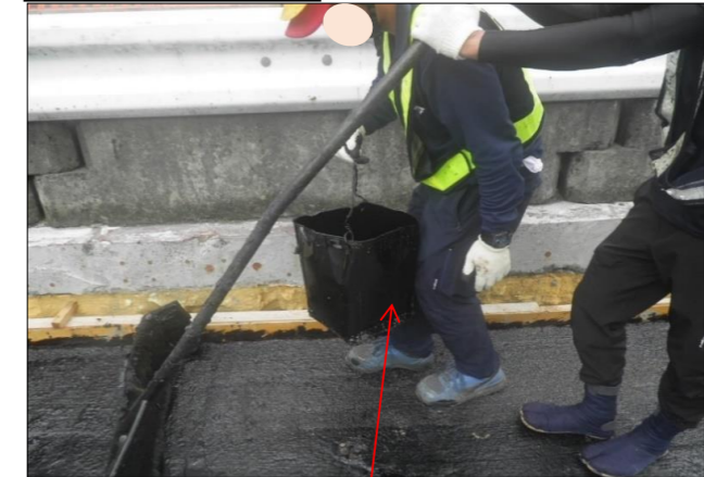
② 施工面と靴が接着し膝で手に持っていた一斗缶を蹴り上げ、中の防水材が衝撃で跳ねて顔に付着、火傷を負う。
