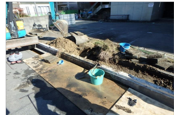
事故状況写真①
