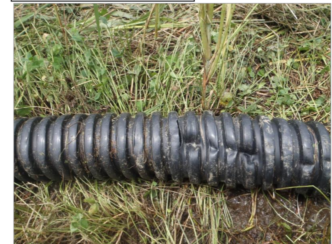
事故状況写真③ 損傷状況
