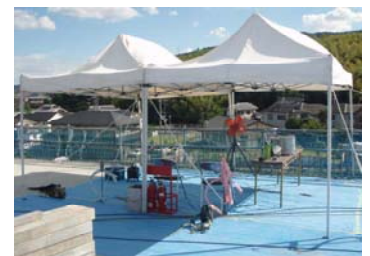
作業場(桁上)の休憩施設
