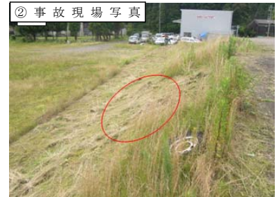
② 事故現場写真
