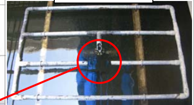
破損状況写真
