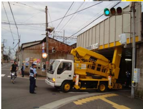
事故状況写真
