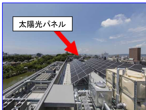
太陽光パネル (屋上)
