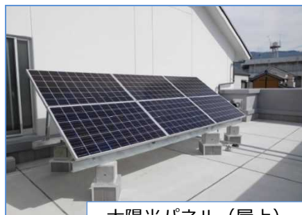
太陽光パネル（屋上）
