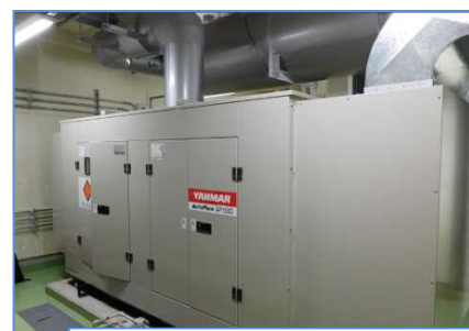
非常用発電機 （燃料は3日分を貯蔵、燃料を補充すれば1週間の連続運転が可能）
