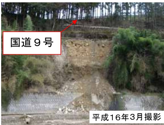
国道9号沿線における崩落状況
