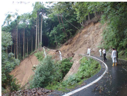
▲土砂崩落の状況
