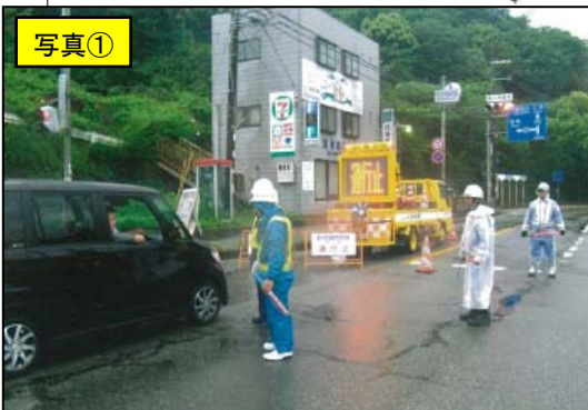
通行止め状況 H23.5.29撮影
