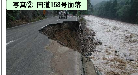
写真② 国道158号崩落 【福井市小和清水町付近 (平成16年7月19日撮影)】
