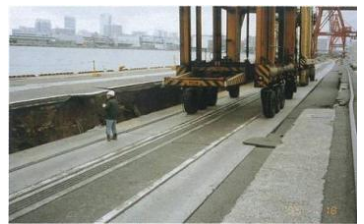
阪神・淡路大震災で被災した神戸港PI PC7-9
