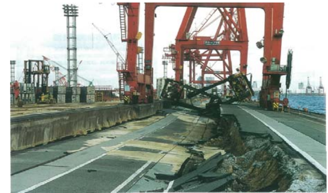
六甲アイランドコンテナターミナルの被災状況
