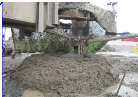
盛り上がり土の発生状況
