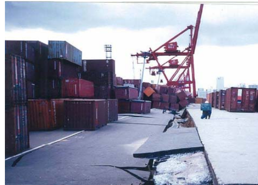
コンテナの被災状況
