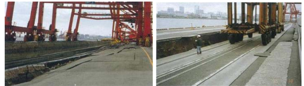
阪神・淡路大震災で被災した神戸港六甲アイランドRC-3
