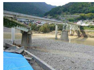
写真① 折立橋落橋後 (撮影時期: H23年紀伊半島大水害直後)
