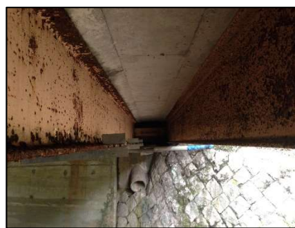
広範囲に激しい腐食
