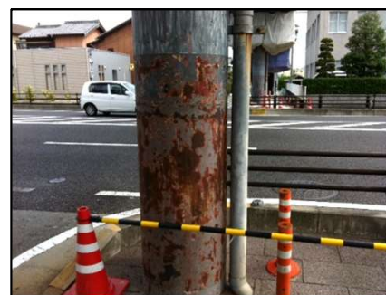
広範囲に激しい腐食
