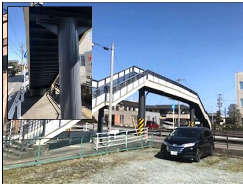
激しい孔食箇所施工後の現状と全景
