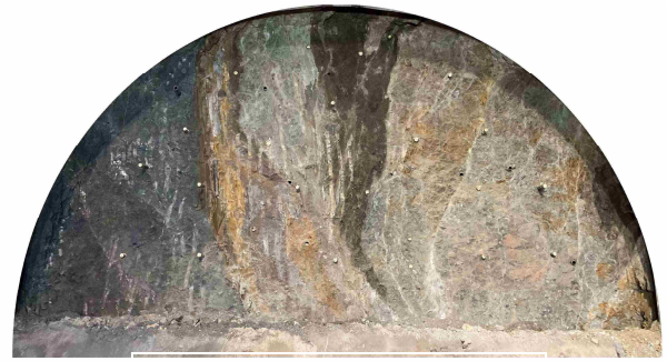
写真-4 断層破碎状況 (TD3231m)
