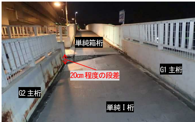
写真-1 桁ずれ発生直後の橋面上の状況
