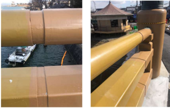
図-13 高欄の新旧の塗装の色の差
