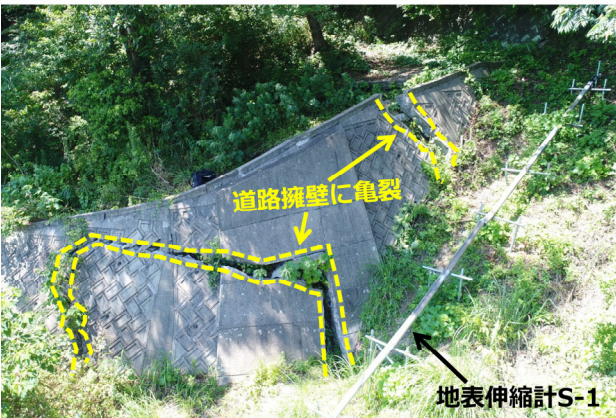
図-4 道路擁壁に生じた亀裂の様子
