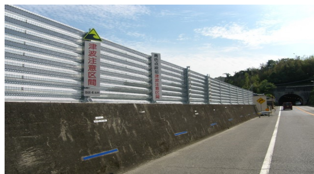
写真-5 越波柵(メタル)
