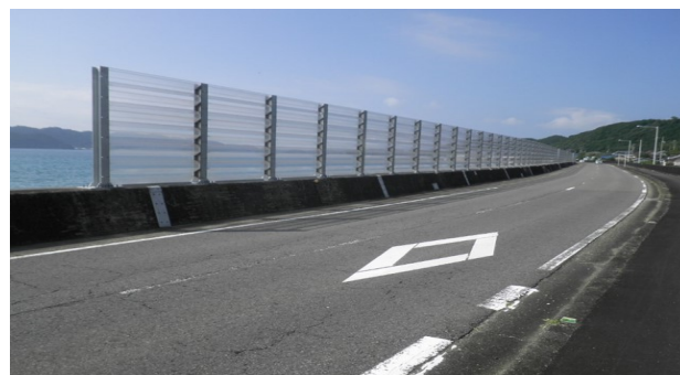
写真-6 越波柵(ポリカーボネート)
