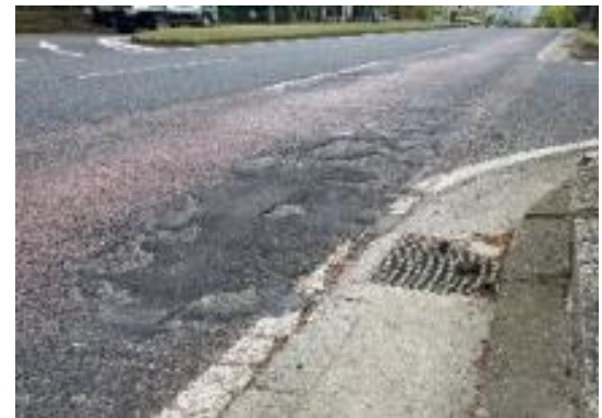
【損傷度Ⅲ：修繕段階】
