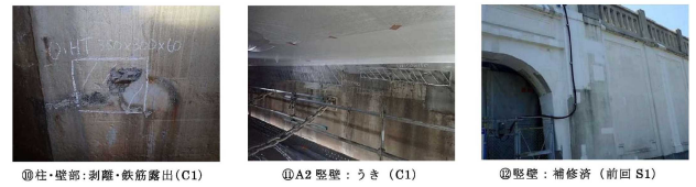
写真-3 橋台の損傷写真
