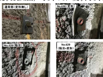
写真4-1 ロックボルト変状写真
