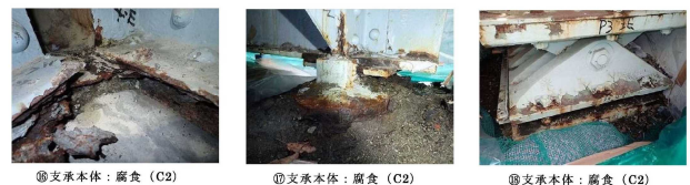
写真-5 支承部の損傷写真
