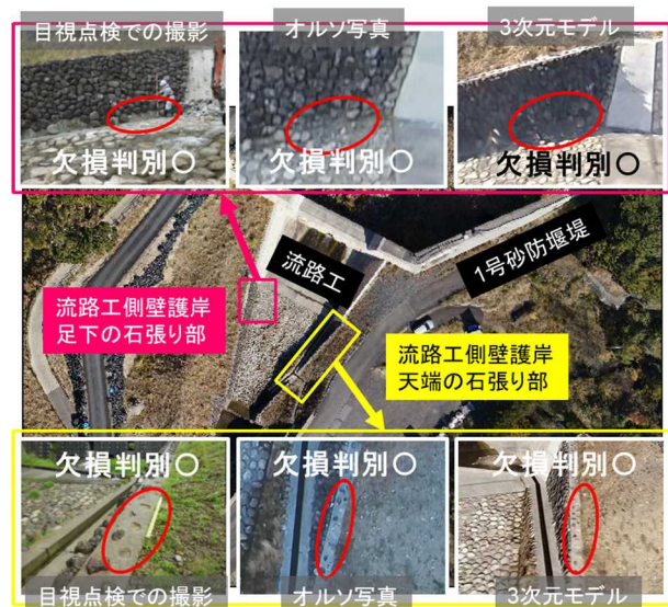
図-8 目視点検による近接撮影, オルソ写真, 3次元モデルのそれぞれによる砂防施設変状の判別
