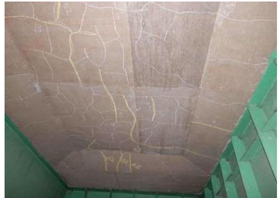
写真-6 第7径間以外の床版ひびわれの状況
