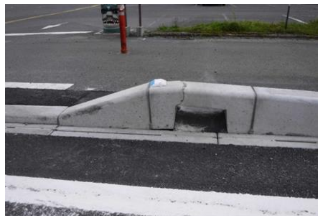
写真-1 縁石(水抜き穴付き)破損状況
