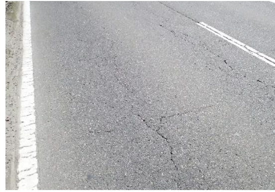
【損傷度Ⅱ：表層保持段階】
