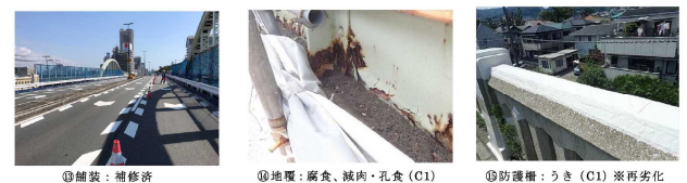
写真-4 橋面等の損傷写真
