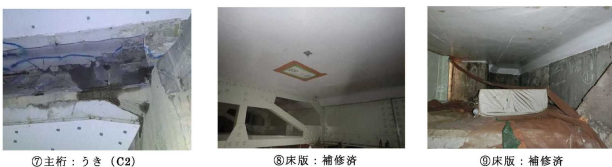
写真-2 コンクリートの損傷写真
