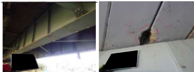
M橋の損傷例(劣化速度:小) H橋の損傷例(劣化速度:小)
