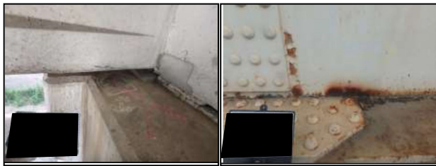
F橋の損傷例(劣化速度:大) H橋の損傷例(劣化速度:大)
