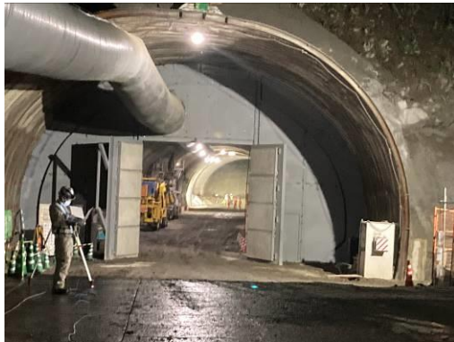
図-11 高富トンネル遠隔通信試行実験状況
