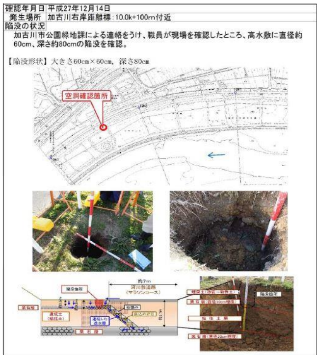
図-10 加古川右岸 10.0k+100m 高水敷陥没状況
