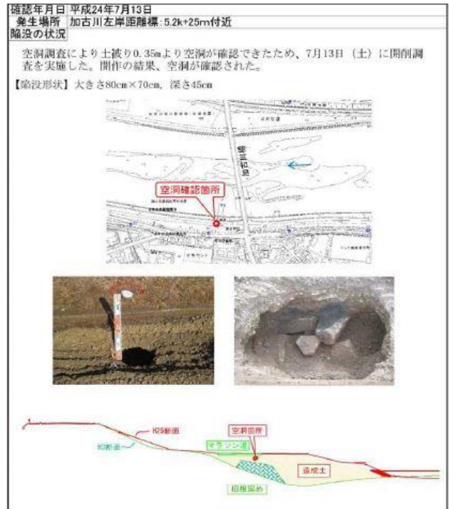
図-13 加古川左岸 5.2k 高水敷陥没状況
