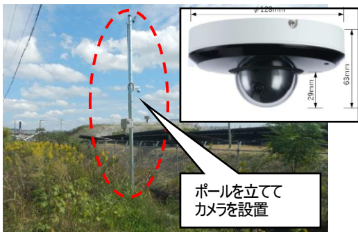
図-2 監視カメラの外観
